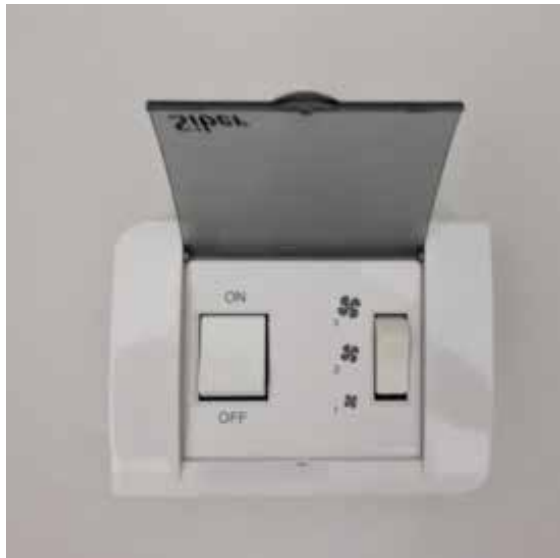
Interruptor Microventilacion en armario instalaciones.
