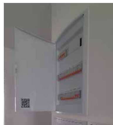
Interior de cuadro eléctrico.
