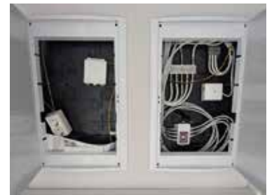
Interior registros de Telecomunicaciones
